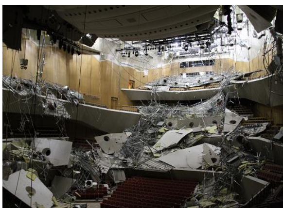
音楽ホールにおける天井等の脱落
